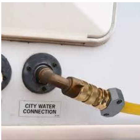
Línea de llenado del tanque no desmontables con un acoplador de desconectado rápido
